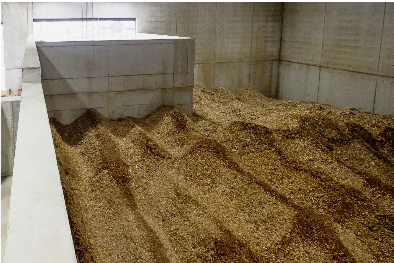
Ein Blick ins 1'965m 3 fassende Holzsilos der Heizzentrale.
