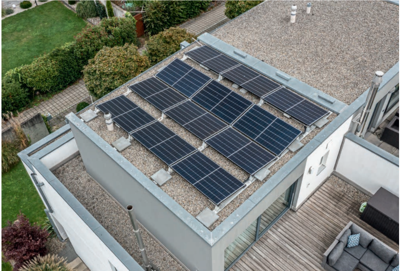
Neue PV-Anlage auf einem Flachdach im Merlachfeld.
